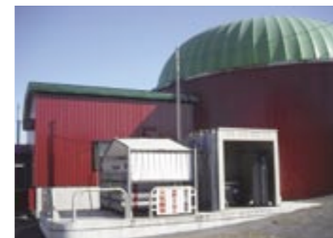
千歳市内提携農場のバイオガス発生施設
