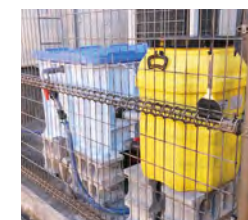
グリストラップの自動洗浄設備
