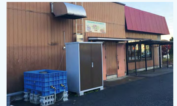
びっくりドンキー太田店に設置したグリストラップ自動洗浄装置
