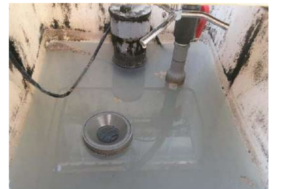
自動洗浄後のグリストラップ内部
