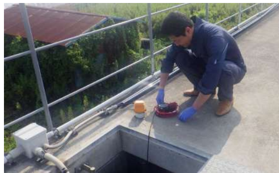
曝気槽のDO（溶存酸素量）測定
